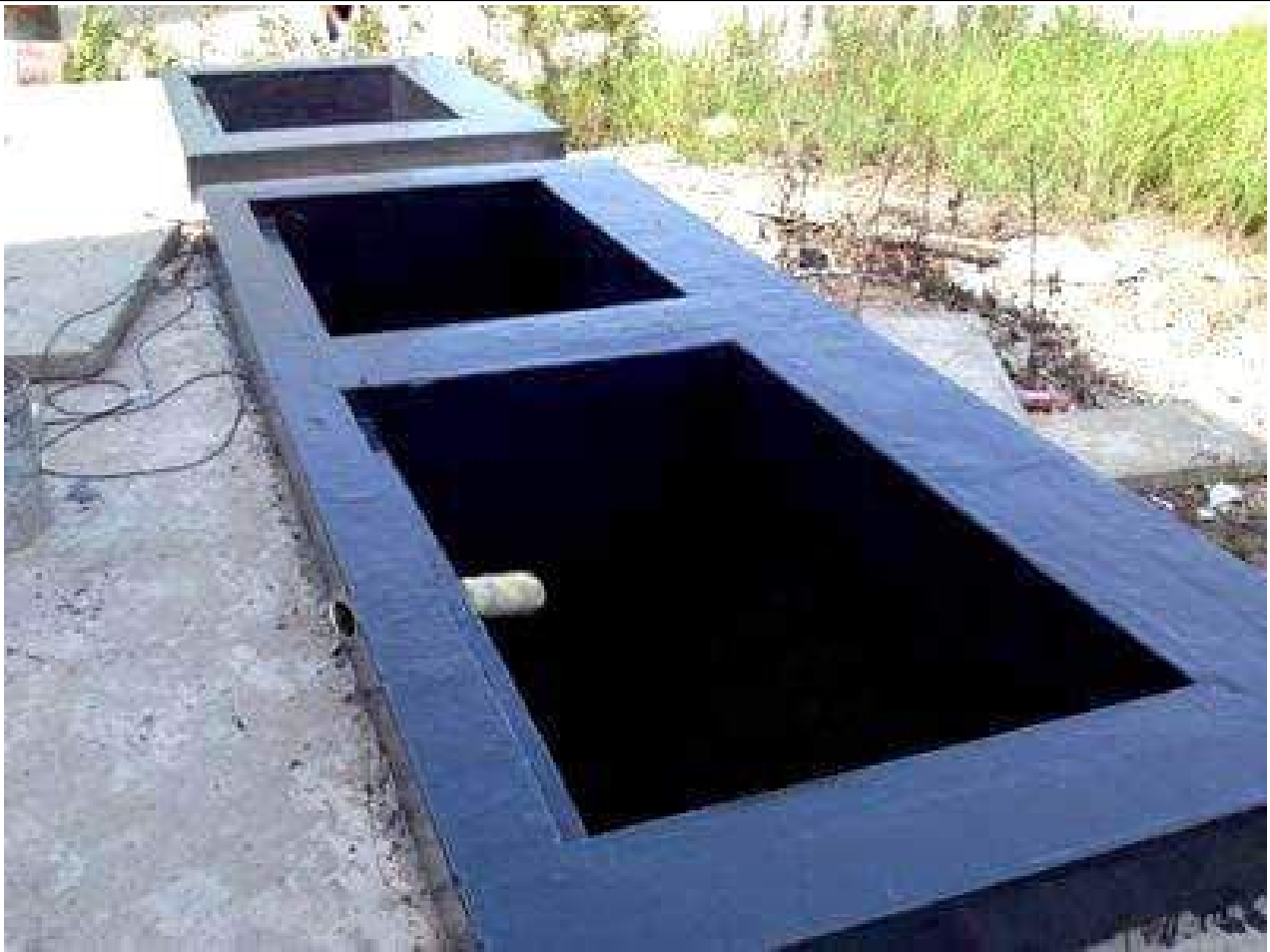
项目初期雨水收集池
